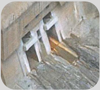
Estructuras susceptibles a la abrasión
