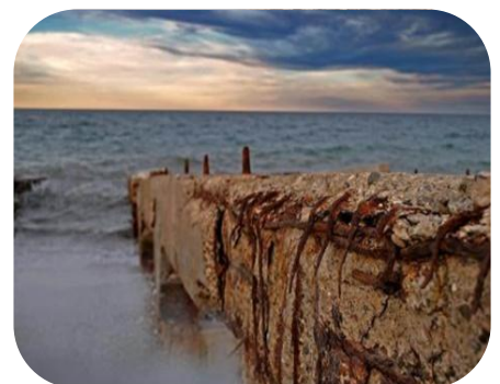
Ejemplo de deterioro de estructuras de hormigón en ambiente marino.
