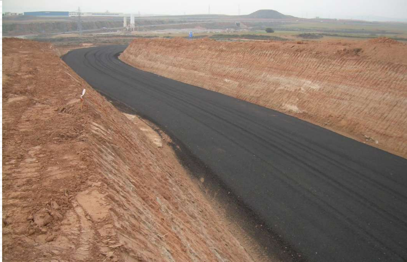
ariblack para aplicaciones en carreteras y viales Subbase Camino Rural Ayuntamiento de Muel
