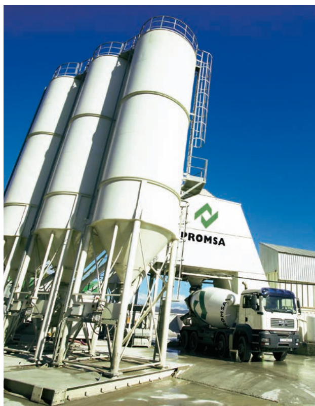
> Instalaciones de fabricación de hormigón, Promsa
