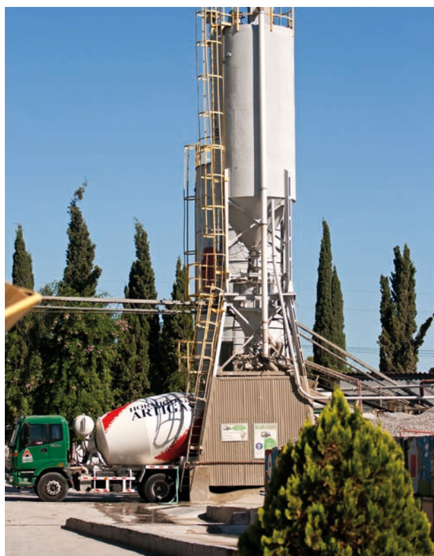
> Instalaciones de fabricación de hormigón de Cementos Artigas, Uruguay
